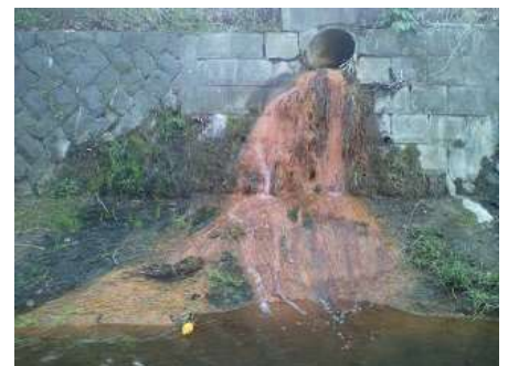
青木橋下流右岸の排水口 (赤茶けている)
