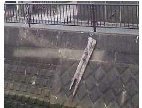
消防団が吊り下げた止水板が腐ってぶら下がった状態(諏訪の橋上流)
